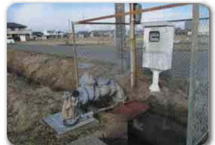
只越第2揚水機
