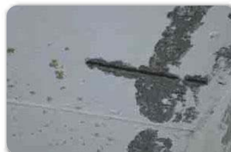
天井面が剥がれ鉄筋が出ている様子
