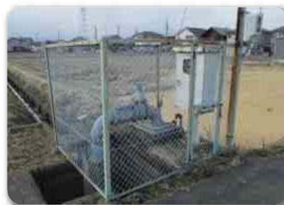
只越第3揚水機
