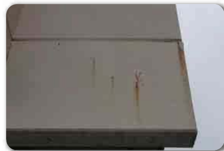
外壁の劣化等、老朽化が目立ちます
