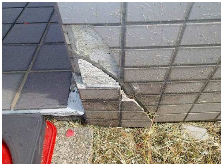
総合センター 外壁タイルの破損
