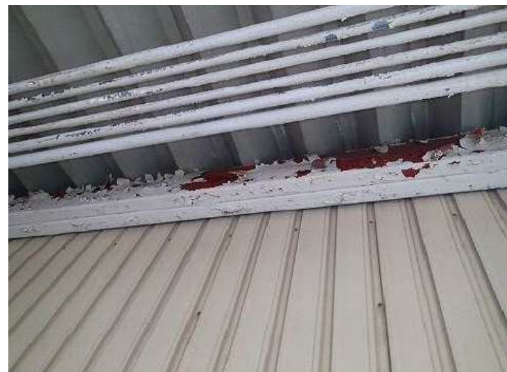
西小学校 屋根 鉄骨の腐食
