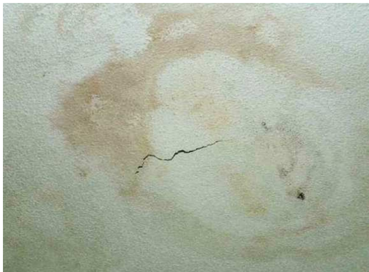
巢南公民館 天井漏水
