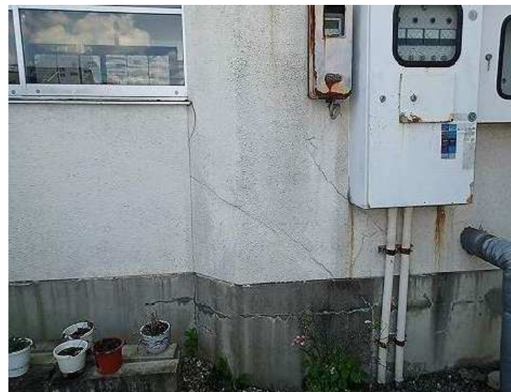
生津小学校 外壁 ひびわれ
