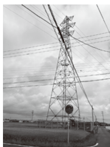
只越にある 高圧線の鉄塔
