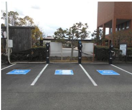
巢南庁舎(巢南公民館)の充電設備
