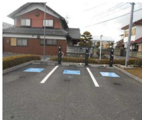
図書館本館の充電設備
