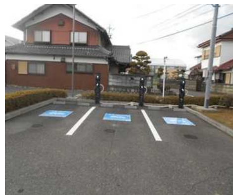
図書館本館の充電設備
