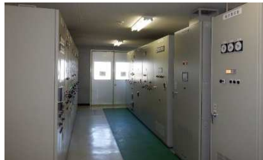
管理棟内部(電気室)
