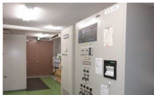
管理棟内部(電気室)
