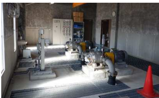
管理棟内部(ポンプ室)
