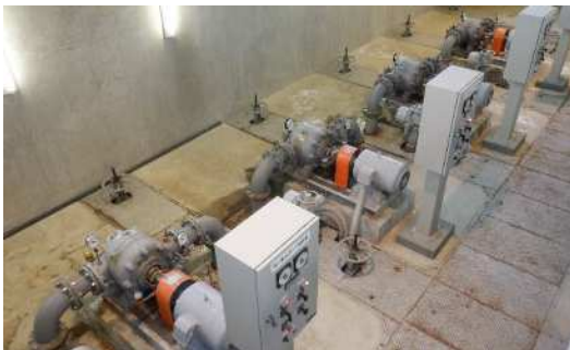
管理棟内部(ポンプ室)
