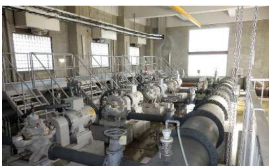
管理棟内部(ポンプ室)
