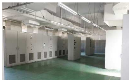
管理棟内部(電気室)
