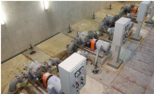
管理棟内部(ポンプ室)
