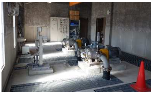
管理棟内部(ポンプ室)
