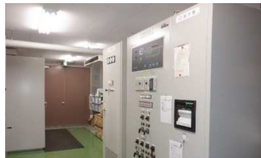
管理棟内部(電気室)
