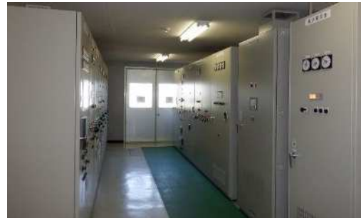
管理棟内部(電気室)
