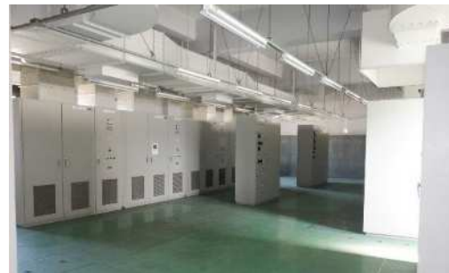
管理棟内部(電気室)
