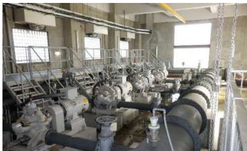
管理棟内部(ポンプ室)
