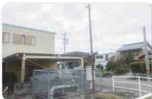
只越第1揚水機
