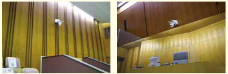
▲議場前後の2台のカメラ。配信用パソコンやカメラなど映像音響機器とインターネット回線工事などを含めて整備しました。
